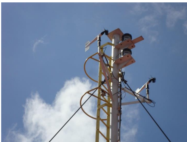
Figura 2. Anemômetros YOUNG instalados em PPER-1.
