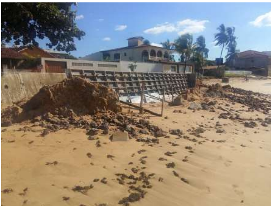
Figura 17 – Estrutura de contenção na praia de Nova Almeida - Serra
